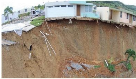
شکل ۱ فروریزش خاک زیر سازه
